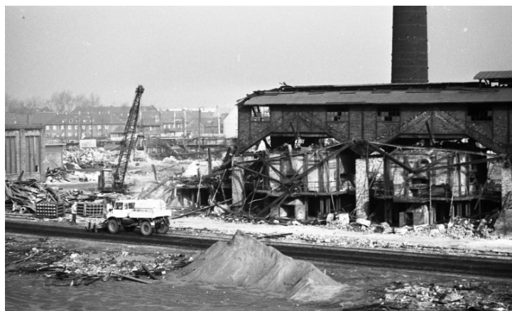
Blick in Richtung Nordwesten: Abbruch der Salzsäurefabrik, hinten Dächer der Wohnhäuser Josefinenstraße
