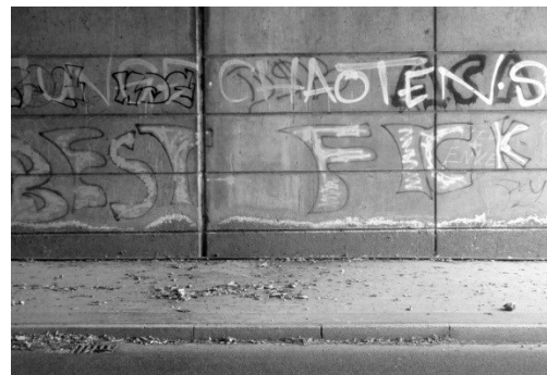
Die Brückenwiderlager „zieren“ wenig appetitliche Schmierereien
