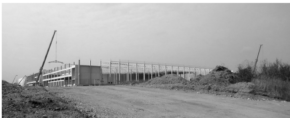
Die Großbaustelle auf dem Gelände der früheren Chemischen Schalke, hier kommen überwiegend vorgefertigte Elemente zum Einsatz
